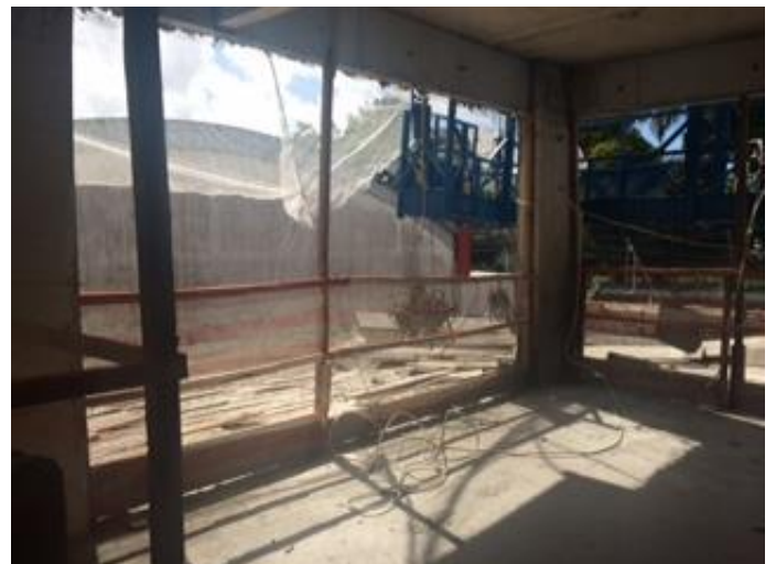
Foto 3: Revisão mecânica dos balancins para serviços da fachada.
